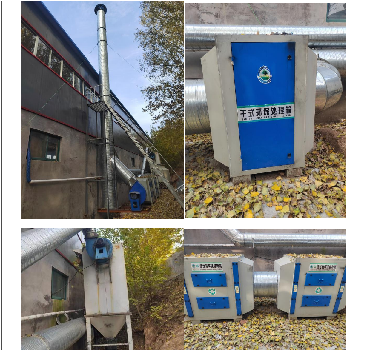
图 3-2 废气排气筒、处理设备及排放口
